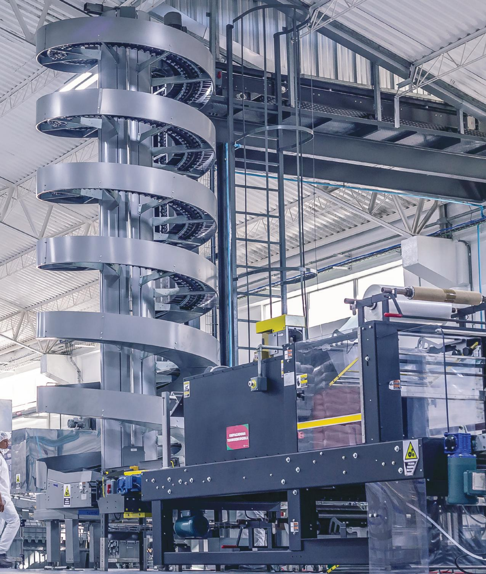
PLANTA DE SOPAS RAMEN - CÉSAR IGLESIAS, S. A. PARQUE INDUSTRIAL, SAN PEDRO DE MACORÍS
